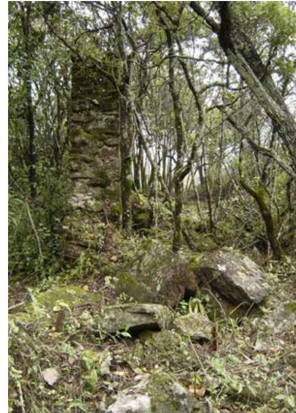
Imagem 32 - Parede em processo de arruinamento. Foto: Henrique Piló.
