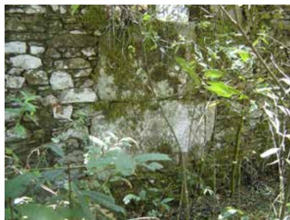
Imagem 77 - Detalhe da janela isolada em fase posterior à finalização da construção. Foto: Henrique Piló.
