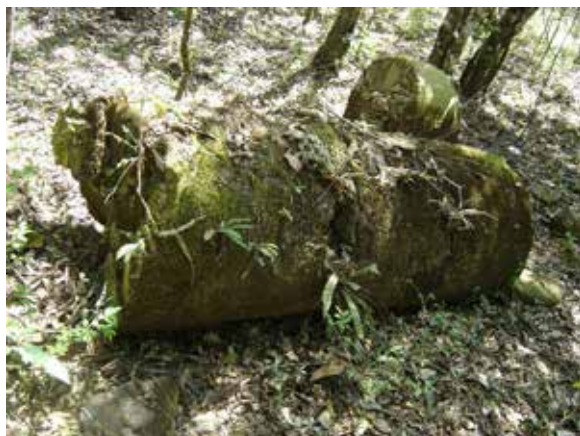
Imagem 73 - Pilar caído, indicando ser a base de uma área pergolada. Foto: Henrique Piló.
