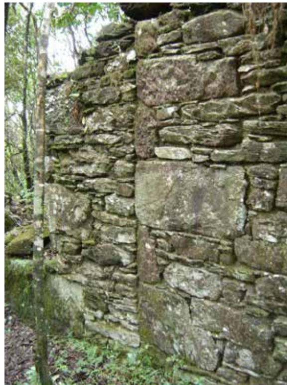
Imagem 31 - Detalhe onde se pode perceber a diferença de material compondo uma mesma parede. Foto: Henrique Piló.
