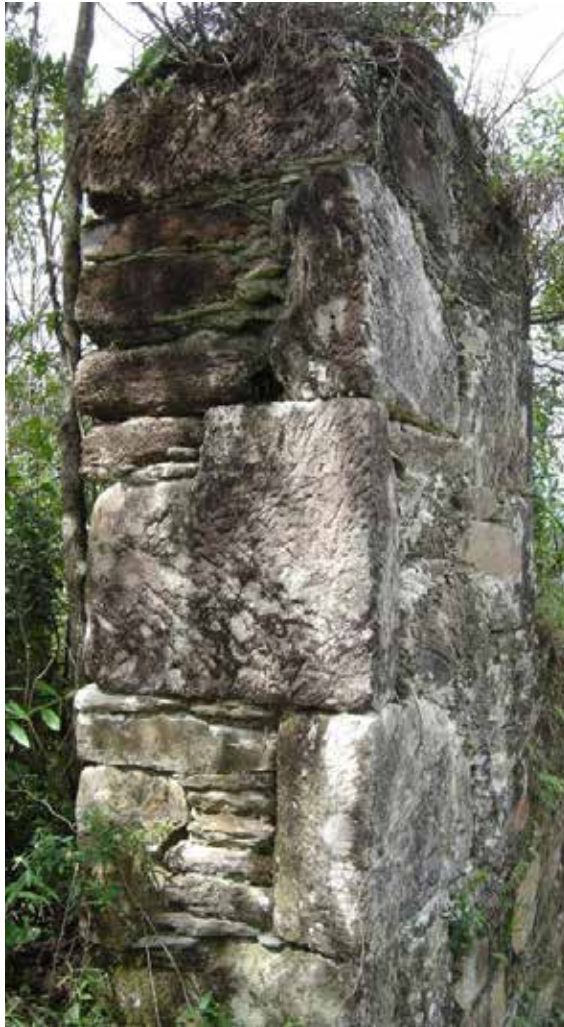
Imagem 24 - Detalhe de parede com marcas de ponteiro para regularizar suas bordas. Foto: Henrique Piló.
