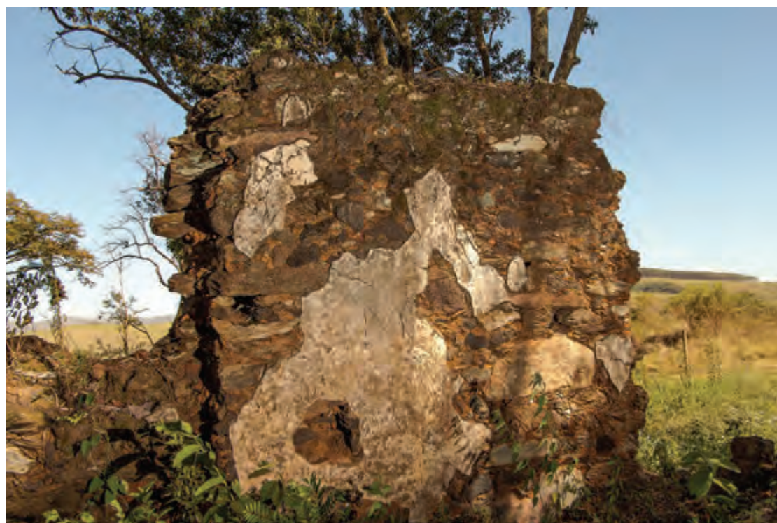
Imagem 12 - Parede com vestígio de reboco. Foto: Henrique Piló
