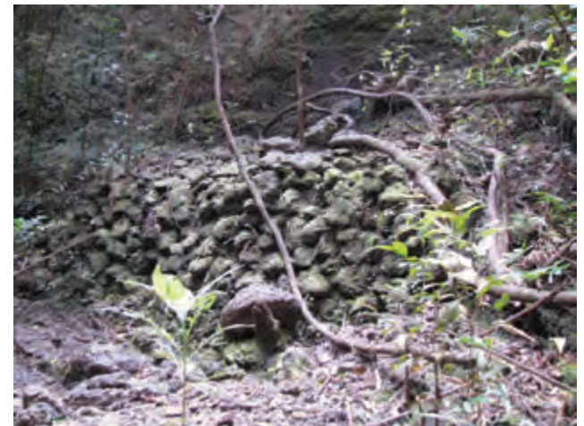
Imagem 50 - Outro trecho do rio com contenção em alvenaria de pedras. Foto: Henrique Piló.
