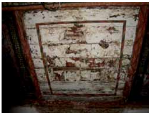
Forro com perdas na policromia Fonte: projeto de restauração da Capela do Rosário de Chapada do Norte Autor: Daniele Gomes
