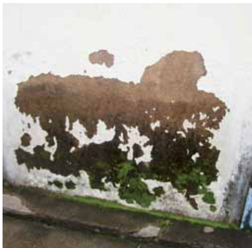
Descolamento de pintura e bolor Fonte: Igreja do Rosário, em Piranga Autor: Andréa Lanna - MPMG
