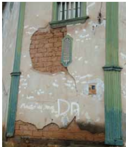
Descolamento de reboco Fonte: Capela Nossa Senhora do Rosário de Rio Vermelho Autor: Andréa Lanna - MPMG
