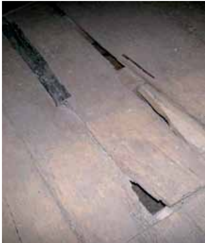
Piso de madeira danificado e com presença de cupim Fonte: Igreja Matriz de Congonhas Autor: Andréa Lanna - MPMG
