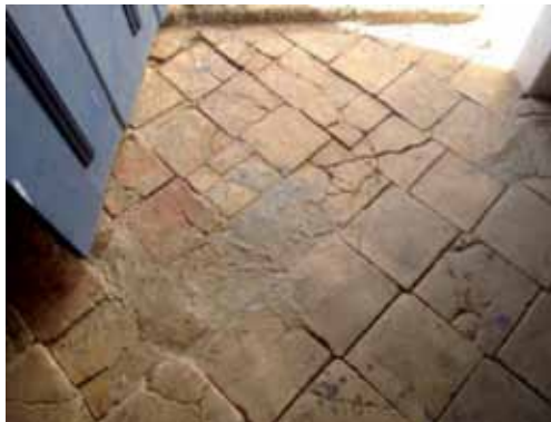
Piso em mezanolo danificado Fonte: projeto de restauração da Capela do Rosário, em Chapada do Norte Autor: Daniele Gomes
