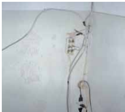
Fiação exposta, com emendas, além de instalação sobrecarregada Fonte: Igreja Nossa Senhora da Ajuda, em Congonhas Autor: Alexandre Novaes - IEPHA-MG
