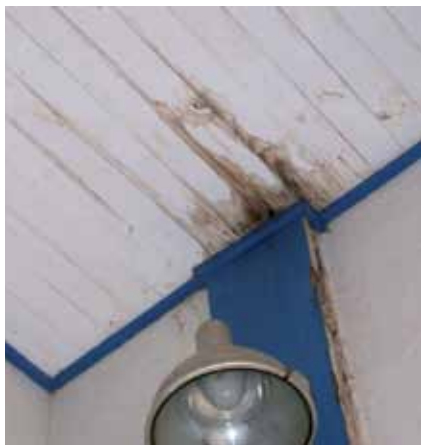
Forro de madeira com manchas de umidade Fonte: Igreja do Rosário, em Piranga Autor: Andréa Lanna - MPMG
