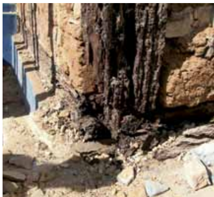
Apodrecimento da estrutura de madeira Fonte: Igreja Santo Antônio, em Sete Lagoas Autor: Andréa Lanna - MPMG
