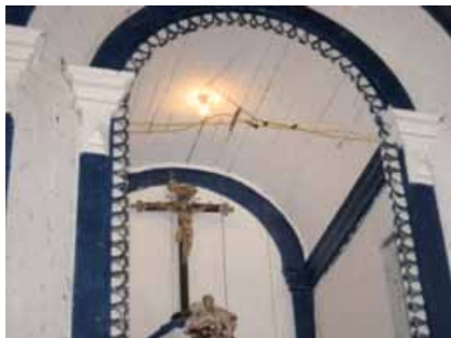
Fiação exposta, com emendas, instalada diretamente no elementos de madeira Fonte: Capela do Senhor Bom Jesus da Lapa, em Chapada do Norte Autor: Alexandre Novaes - IEPHA-MG
